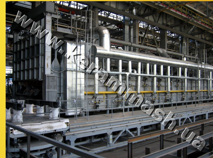
Піч прохідна газова ТермоГаз® - ЛО-20.40.15/1250 (ООО «ВКМ-Сталь»)
